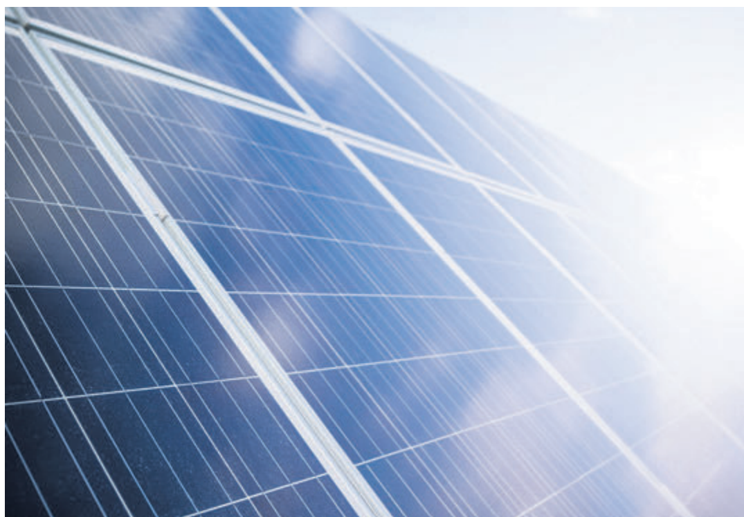
Bis Ende 2021 wurde die Einspeisevergütung verlängert. Liechtenstein unterstützt den Bau von Fotovoltaikanlagen derzeit in drei Optionen. Bild: iStock
