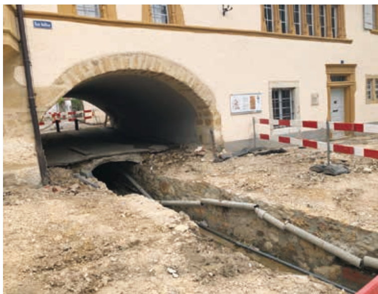
Cressier bei Neuenburg – zwei Bächlein haben als Sturzflüsse den Dorfkern überflutet, zurück blieb ein Millionenschaden an Strassen und Häusern.
